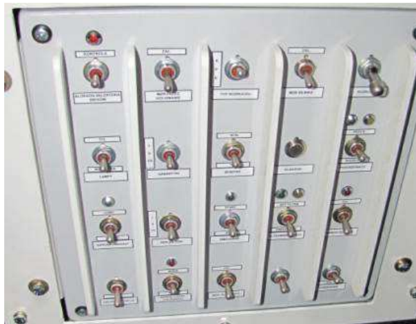
Rys. 4. Zmodernizowany panel przełączników [materiał własny]
