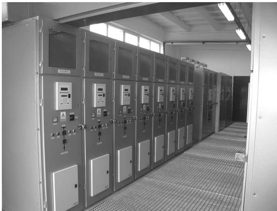
Rys.9. Widok rozdzielni grzewczej na kolejowej stacji postojowej Warszawa-Grochów
