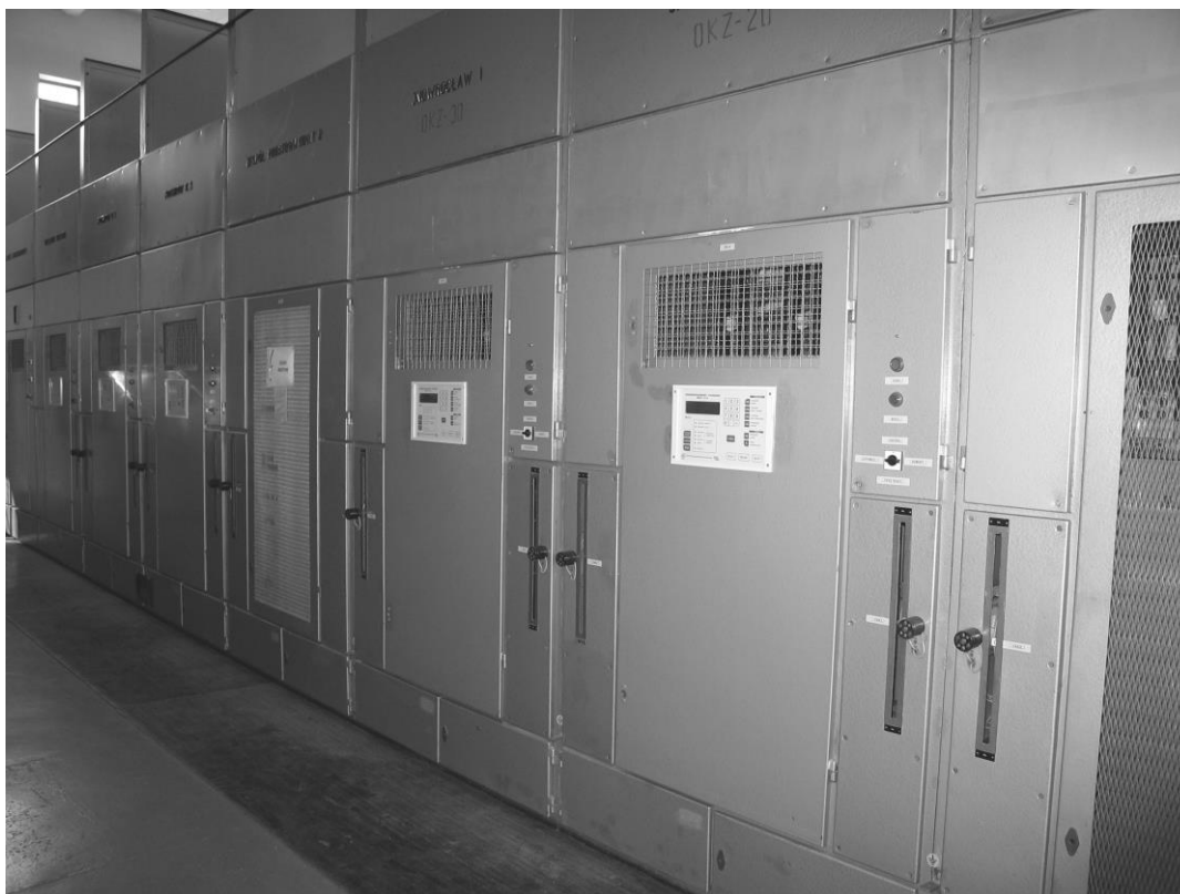
Rys.1. Rozdzielnica 3kV DC z zamontowanymi sterownikami MSC-3 (podstacja zmodernizowana)
