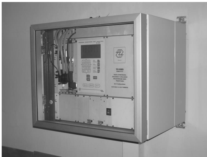
Rys.7. Szafa sterowania grupami odłączników sieci trakcyjnej TC-SSO
