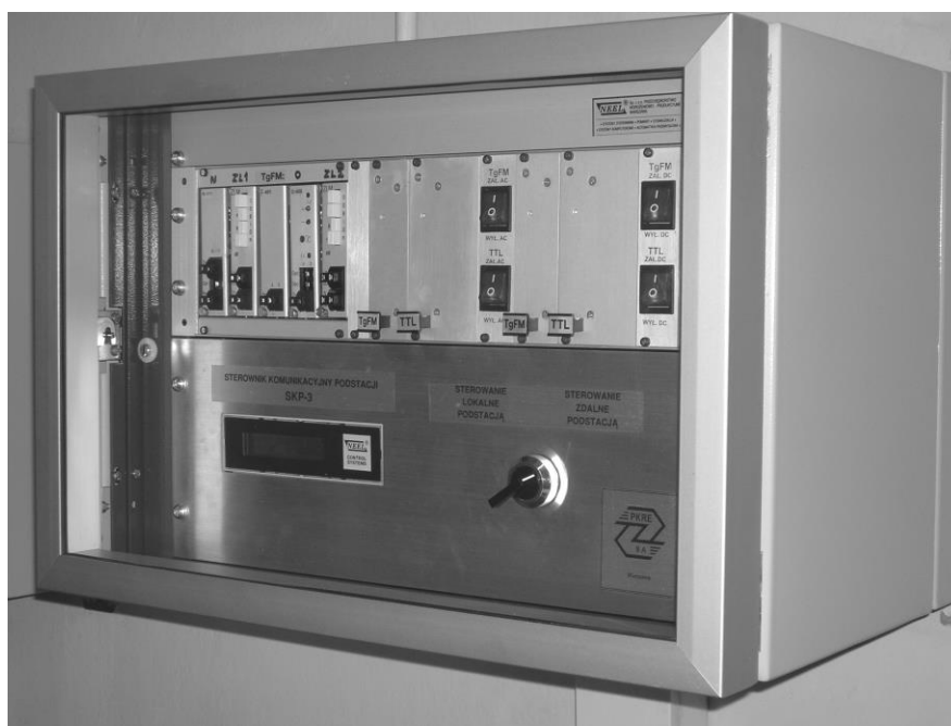
Rys. 5. Sterownik komunikacyjny podstacji SKP-3
