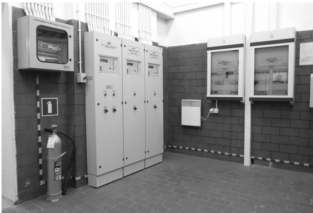
Rys.2 Pomieszczenie automatyki CAN/RS-485 w nowowzbudowanej podstacji trakcyjnej
