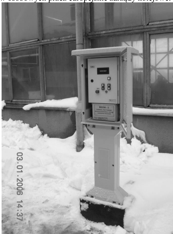
Rys.8. Przytorowy terminal ogrzewania składów wagonów
