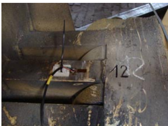
Tens. t12 – ucho przy sworzniu przęśla głównego
