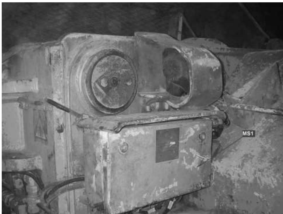
Rys. 4. Moduł sterujący MS 1 po zawale skał stropowych
