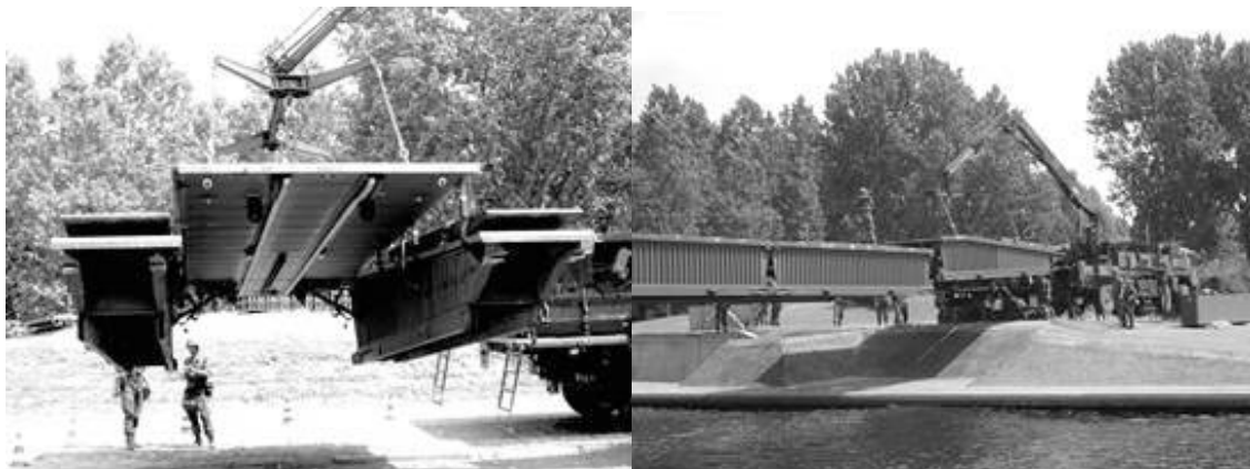
Rys. 2. Montaż mostu DoFB, segment najazdowy w trakcie podnoszenia i układanie segmentu na przęśle pomocniczym
