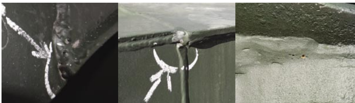
Rys. 5. Wady spoin ujawnione metodą VT – widoczne niezgodności spawalnicze dotyczące kształtu i wymiarów, pustki, przyklejenia i brak przetopu
