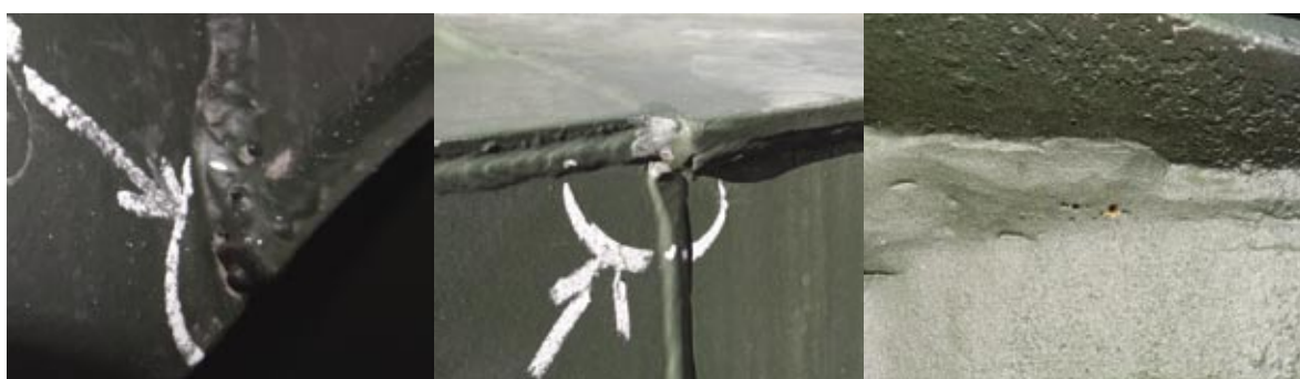
Rys. 5. Wady spoin ujawnione metodą VT – widoczne niezgodności spawalnicze dotyczące kształtu i wymiarów, pustki, przyklejenia i brak przetopu
