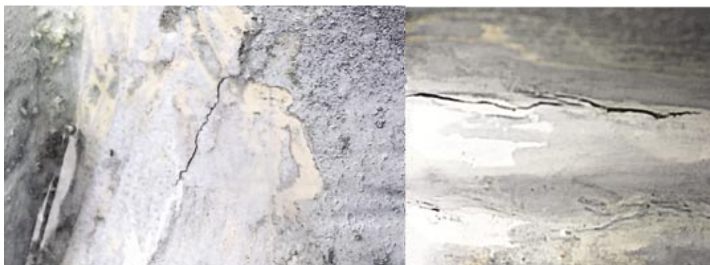
Rys. 7. Przykłady wyników badań spoin metodą MT – widoczne niezgodności spawalnicze w postaci pęknięć
