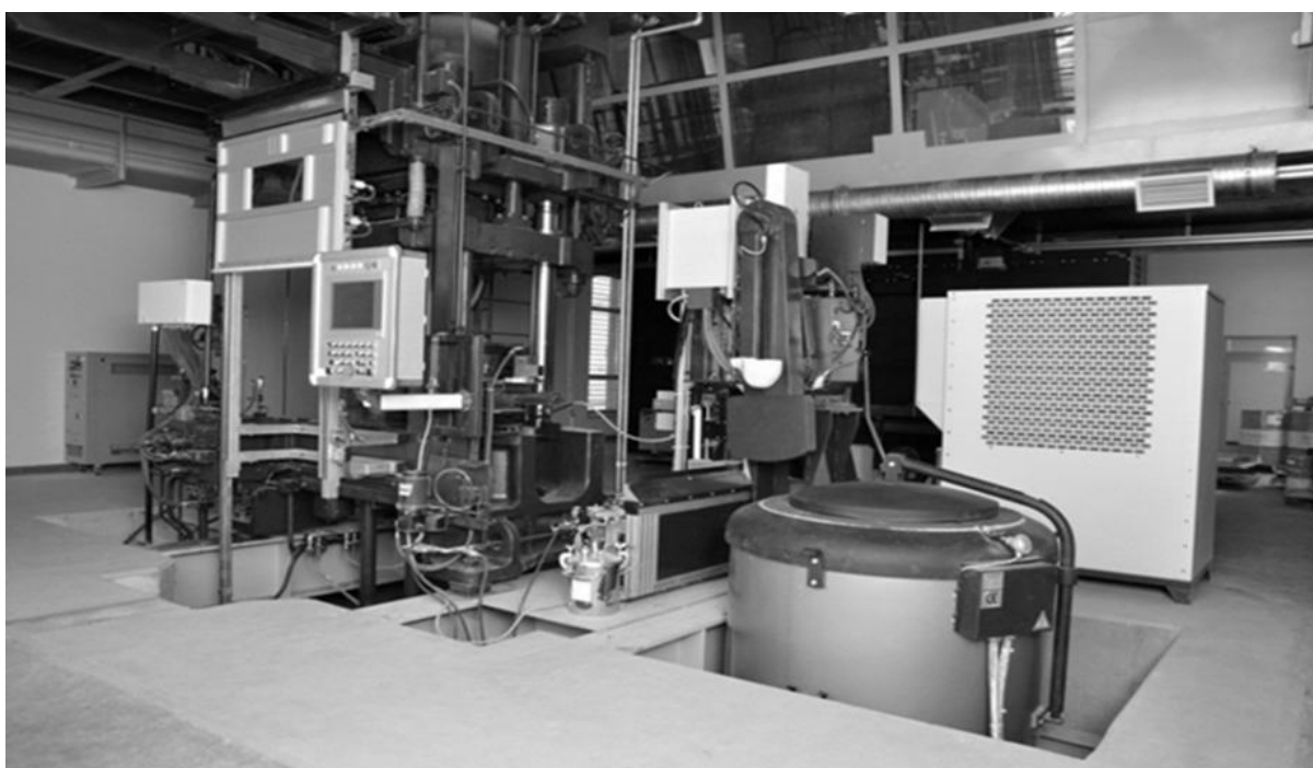
Rys. 7. Unikalne w skali środkowoeuropejskiej kompleksowe stanowisko do prasowania w stanie ciekłym UBE VSC 500
