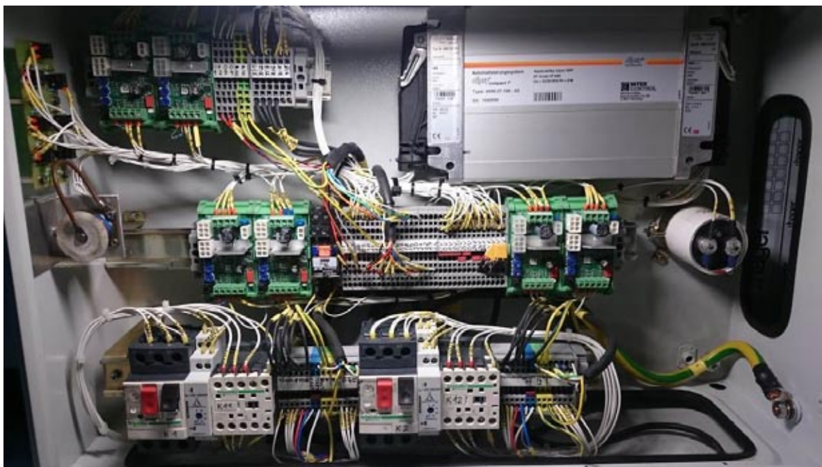
Rys. 5. Zmodernizowany układ sterowania zabudowany w skrzynce SRK
